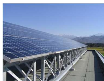
立山工場 太陽光発電装置
